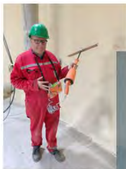
2023-04- Cournonterral Sainte Cécile ça avance aussi on est à l'étape de balais diélectrique avant couche de finition bleu!
