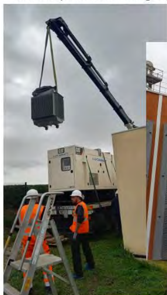
2023-10-Le 23 octobre nouveau transfo. Fiabilité et performance énergétique
